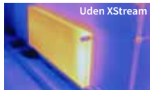
Radiator med luftblokeringer foroven og smudsblokeringer forneden
