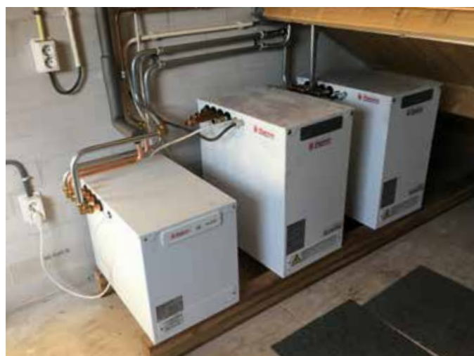
Drie in serie geschakelde FlexTherm Eco's zorgen er voor warm tapwater en verwarming.
